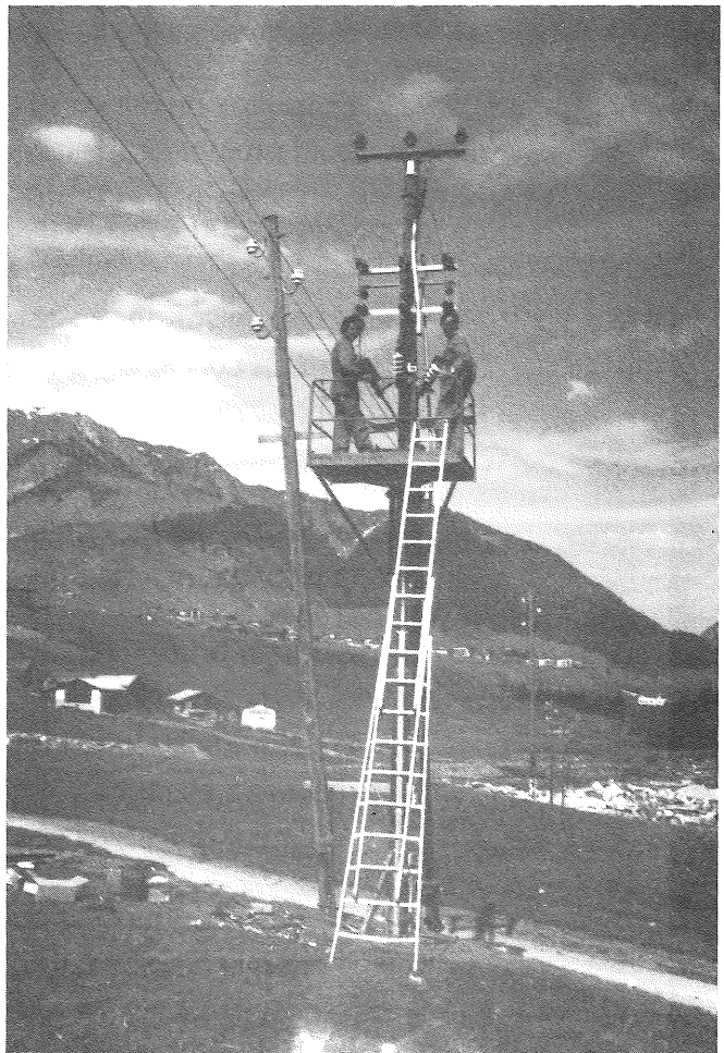
Colligaziun da tensiun aulta, casa da maschinas Val Giuf
